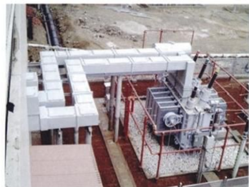
电厂启备变回路共箱母线应用
