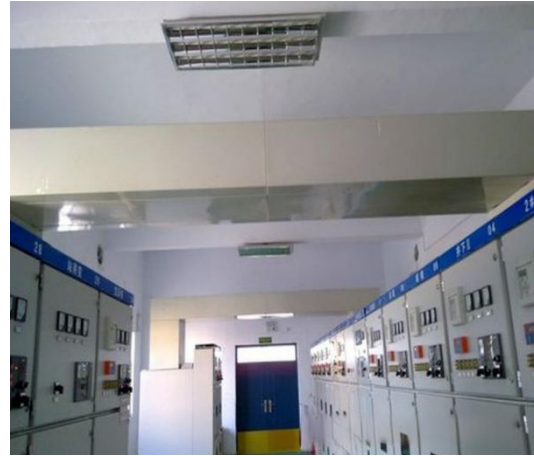
高压室配电柜联络共箱母线应用
