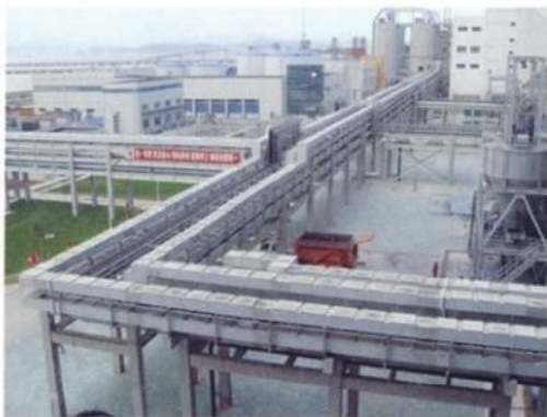
电厂厂用回路共箱母线应用
