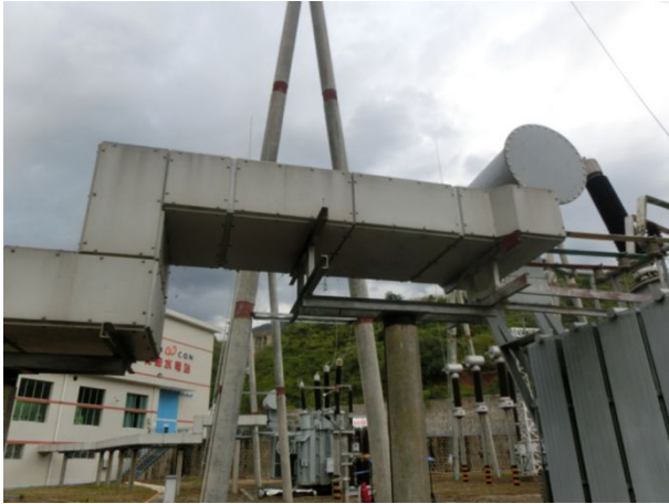
水电站出线主变共箱母线应用
