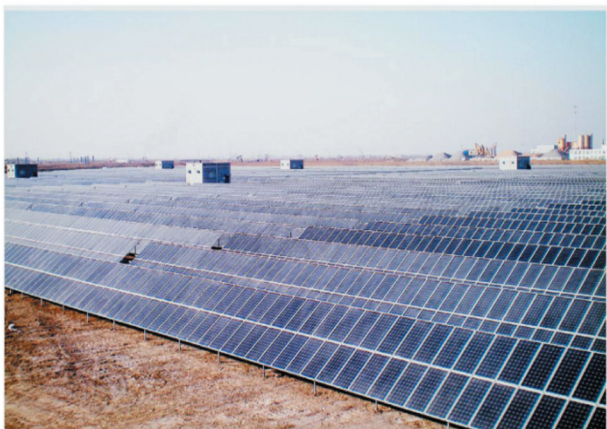
黄河水电青海共和三塔拉光伏发电项目
